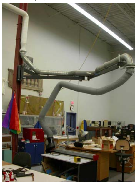
圖 30 吸塵通風設備
