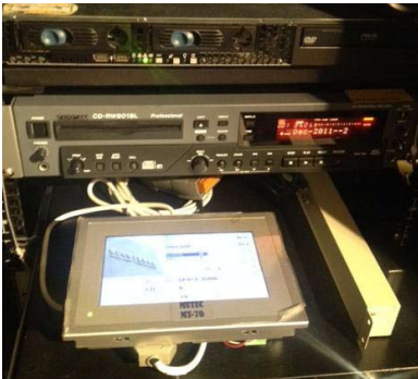
TASCAM錄放音機+PLC自動控制主機
