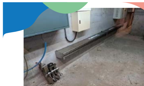
防水閘門設置
