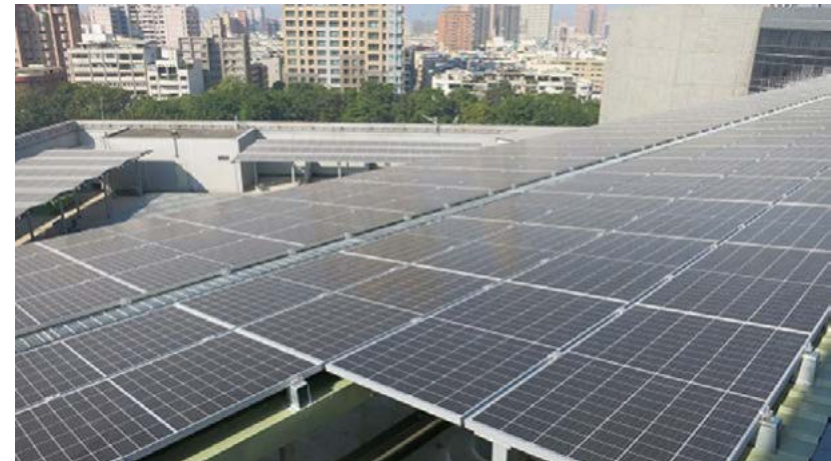
屋頂設置太陽光電發電設備
