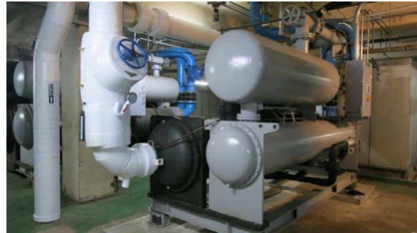
增設冰水主機
